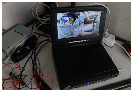
рис.20 Видеорегистратор, установленный в кабине
